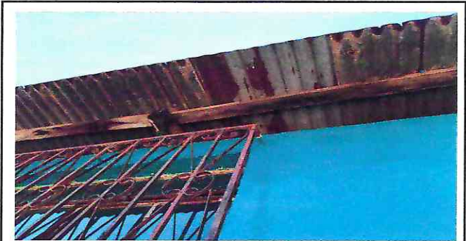
Foto 2: costanera de madera podrida. Techo inestable.
