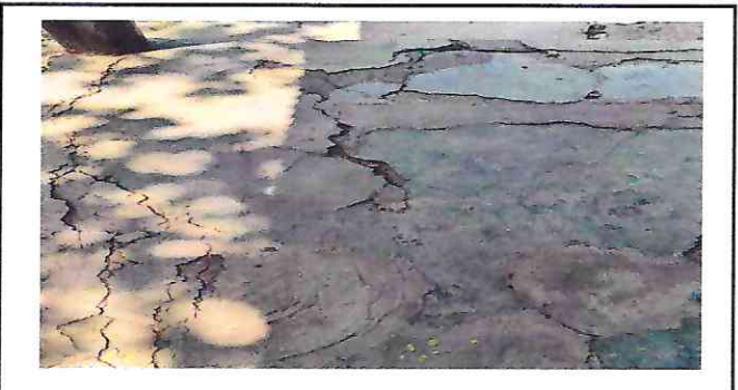
Foto 4: piso liso deteriorado.
