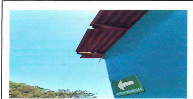
Foto 1: Lámina en mal estado
